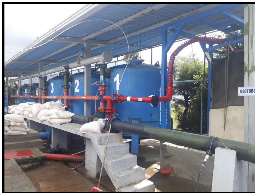
Figura 22. Planta de Tratamiento de Agua Potable Alegrías
