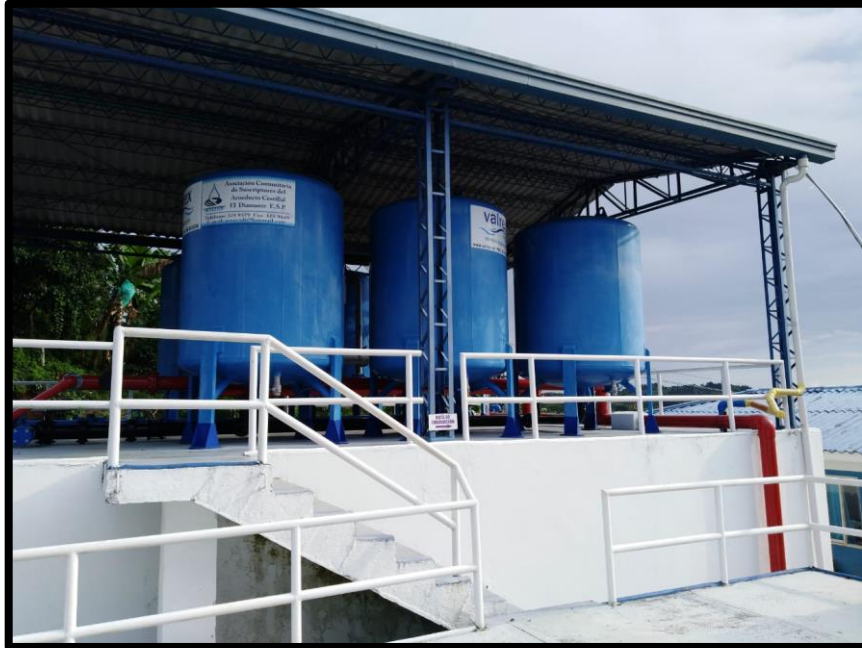
Figura 24. Planta de tratamiento Pérez
