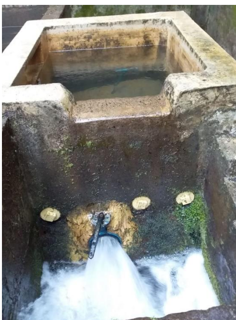
Figura 6 Sistema de medición y control de caudales Cestillal Alto
